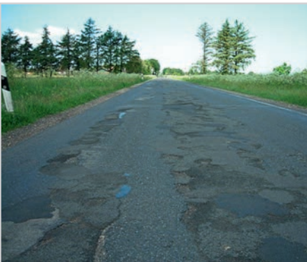
Abbildung 5: Schadstellen im Streckenbereich als Indiz für mangelnde Tragfähigkeit
