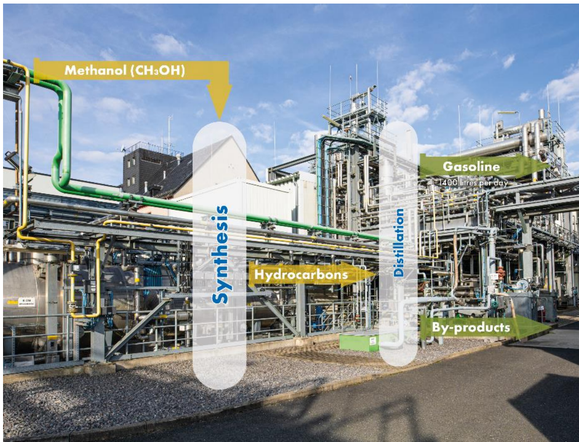
Methanol-to-Gasoline-Prozess in der Benzinsynthese-Großversuchsanlage
