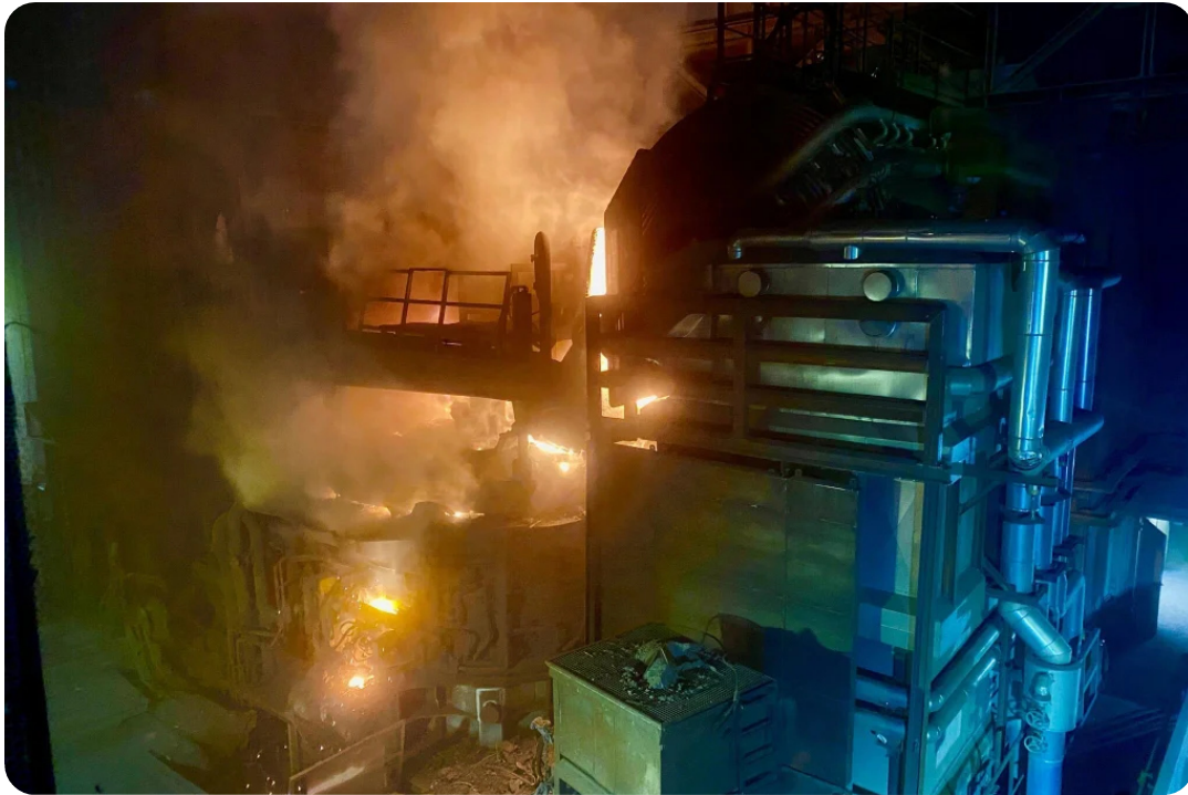
Verbraucht in 40 Minuten so viel Strom wie ein Haushalt in zehn Jahren: der Elektrolichtbogenofen in Riesa. Bild: Oliver Hach
