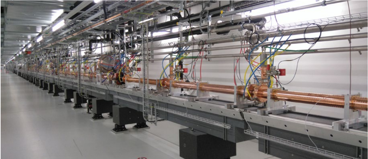
Abbildung 3: Vakuumrohre aus Kupfer im 740 m langen Tunnel des SwissFEL (Schweizer Freie-Elektronen-Laser) in Villigen, Schweiz.
