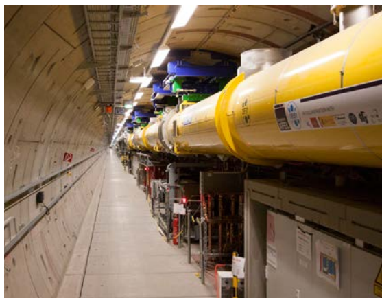
Abbildung 1: Beschleunigertunnel des European XFEL Mitte 2015.
