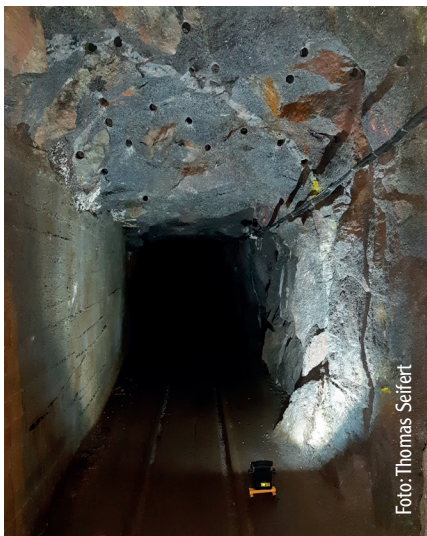
Abb. 11: Massiver Li-Glimmer-Quarz-Topas-Metabasitgranit-Greisen im Bereich einer Großprobenahe-Lokalität durch die Bergsicherung Freital für mineralogisch-geochemische Untersuchungen und Aufbereitungsversuche (vormals SolarWorld Solicium GmbH, aktuell Deutsche Lithium GmbH). Ein steil- bis mittelsteil einfallendes Quarz-Trum der Sn-W-Assoziation (bis 0,1 m mächtig) durchschlägt den Greisenkörper am Oststoß und an der Firste. Besucherbergwerk "Vereinigt Zwitterfeld zu Zinnwald", Tiefe Bünau-Stollensohle.
