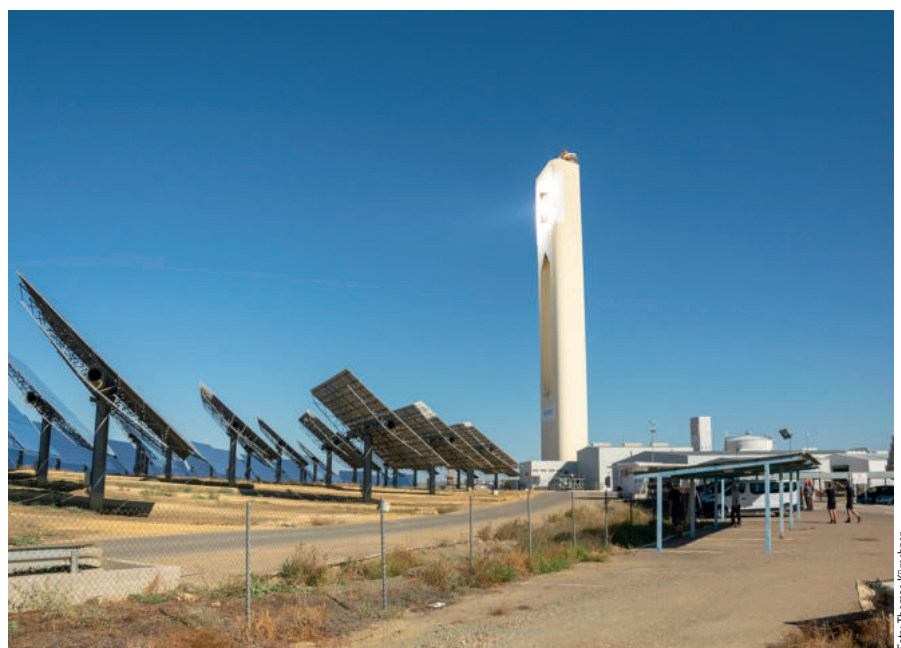
Abb. 15: Sonnen-Turm PS 10 mit einer Leistung von 10 MW, Solarturmkraftwerk im Gebiet Sanlúcar la Mayor in der Nähe von Sevilla. Ein zweiter Turm, PS 20, hat eine Leistung von 20 MW.
