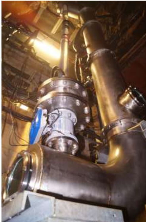
Airliftanlage, TU Bergakademie Freiberg, Forschungsbergwerk „Reiche Zeche“
