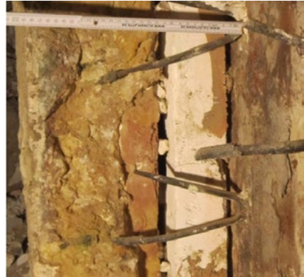
Abbildung 9: Querschnitt der Einlaufkammerwand nach zweijähriger Laufzeit, von links nach rechts (heiß nach kalt): brauner Feuerbeton, weiße SILCAL 1100-Wärmedämmschicht, dunkelbraune Ofenaußen-Blechwand mit angeschweißten Stahlankern
