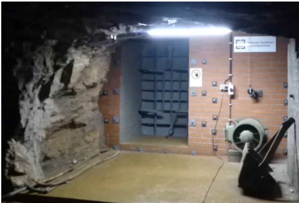
Neuer Eingang der Sprengkammer des Schockwellenlabor wenige Sekunden vor der Testsprengung am 26.08.2019 (fot. Videoausschnitt)
