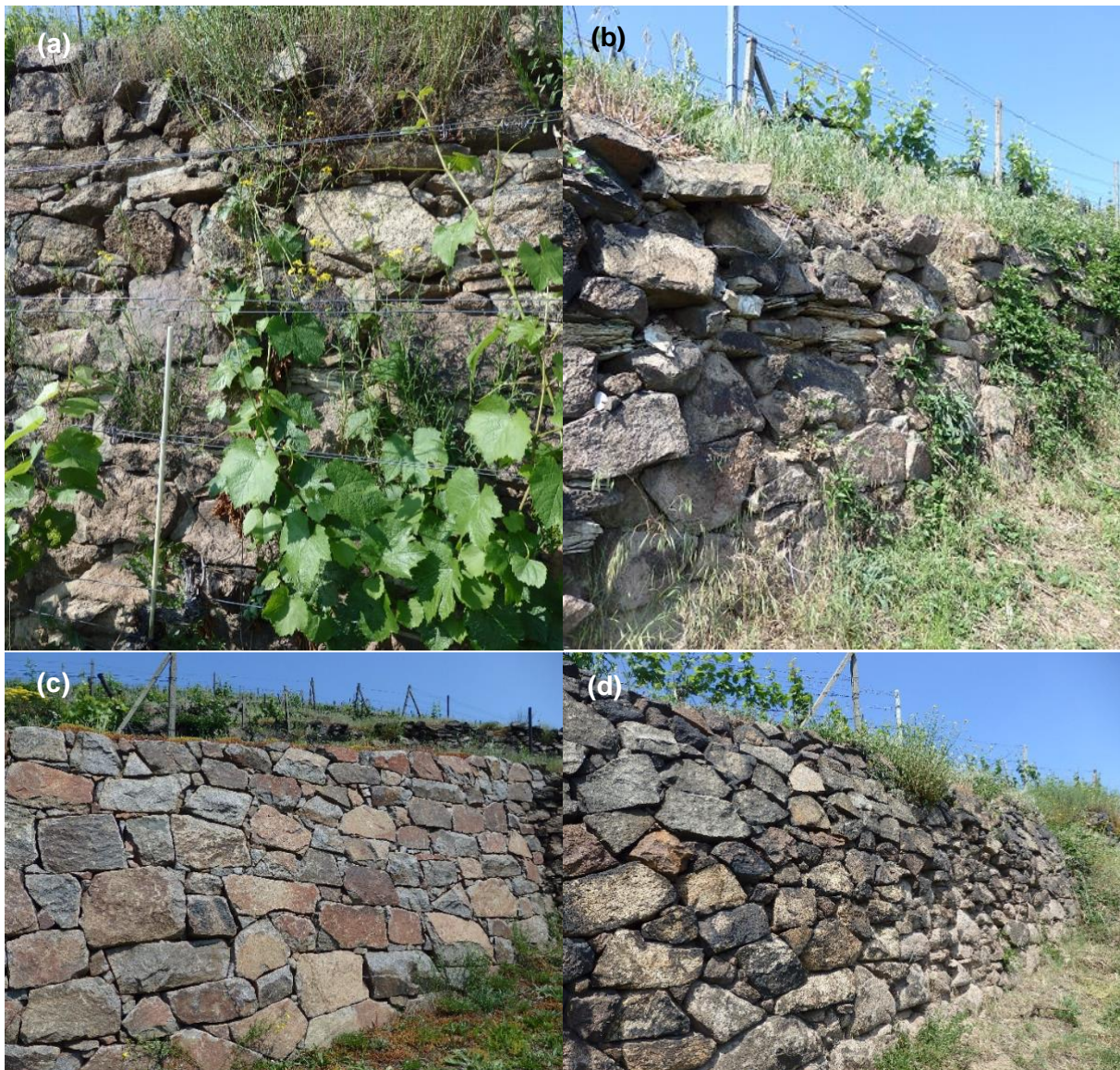
Abb. 5: Fotos ausgewählter Mauerabschnitte: (a) 1W-M5 (mittelmäßiger Zustand), (b) 2W-M6 (erheblich beschädigt), (c) 3W-M1b (neu gesetzt), (d) 2W-M2 (geringe Schäden) (Fotos: Christine Dittrich).
