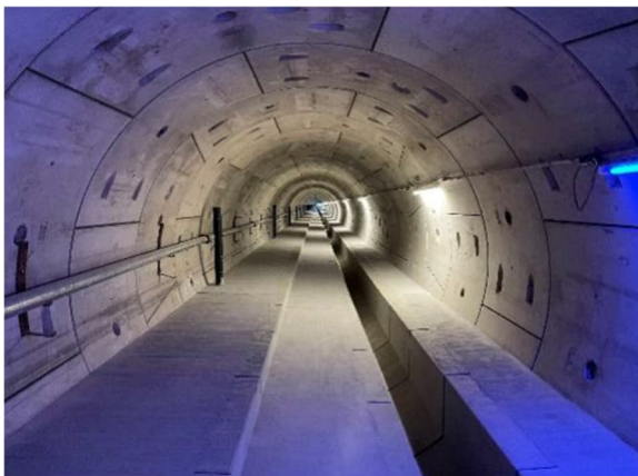
Abbildung 1: Fertig ausgebauter GWKI als Drainagetunnel
