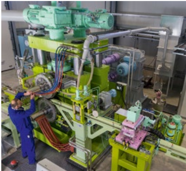
Abb. 1: Das Gießwalzgerüst als Herzstück der neuen Anlage
