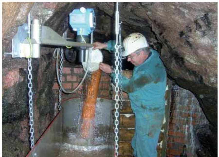
Geothermische Grubennutzung, Eichen des Messwehres. Foto: Andreas Benthin
