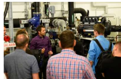
Exkursion zum Kältenetz Kältenetz "Campus Kälte" der TU Bergakademie Freiberg
