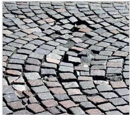
Abbildung 6: Fehlerhafter Pflasterverbund infolge von Absenkungen
