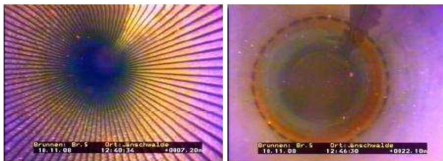
Abb. 5: Beläge auf dem Filterrohr (links) und Ablagerungen im Sumpfrohr (rechts) geben Hinweise auf partikuläre Eisenhydroxide (Quelle: DGC 2009)
